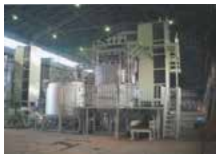
3.0t/hアルミ溶解設備
