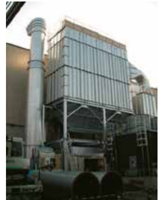
集塵装置(集塵機／屋外)
