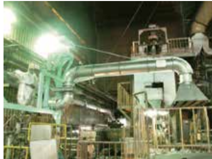
集塵装置(ダクト・フード／屋内)
