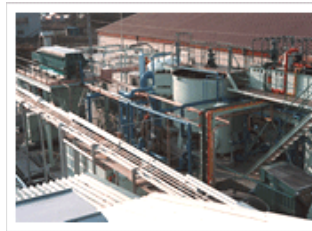
廃水処理プラント
