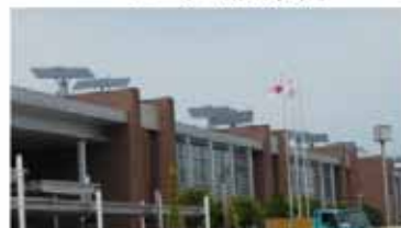
追尾式太陽光発電システム (2010年3月 利府町庁舎に設置)
