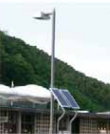
太陽光発電式LED照明
