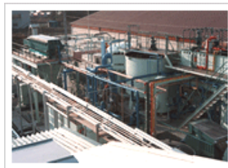
廃水処理プラント
