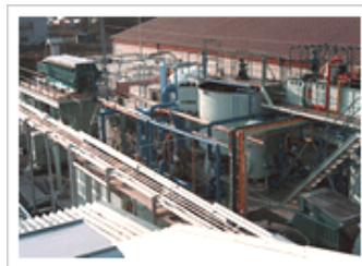
廃水処理プラント
