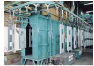
塗装ライン 設備
